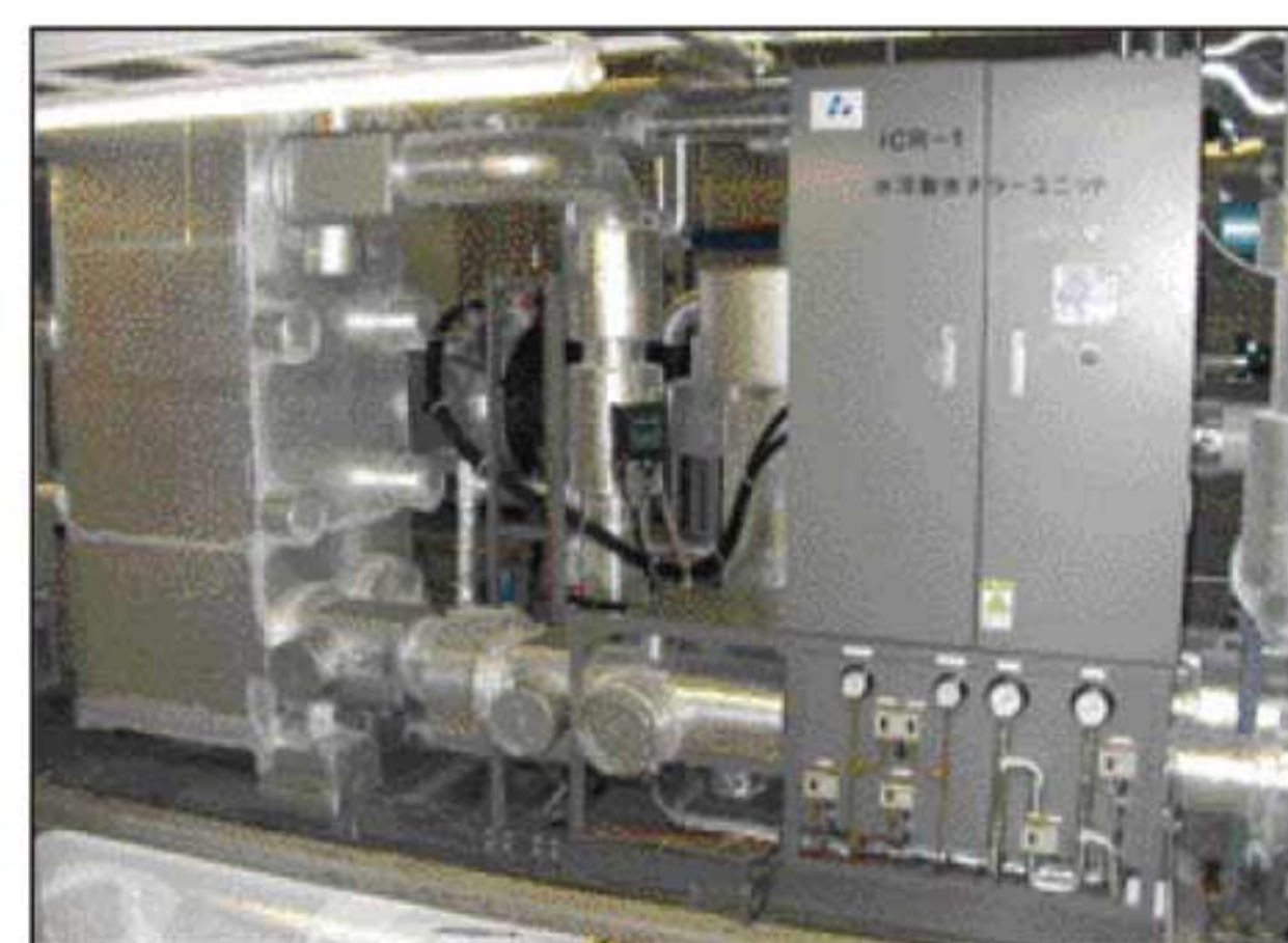
■水冷製氷チラー(某事務所ビル)
