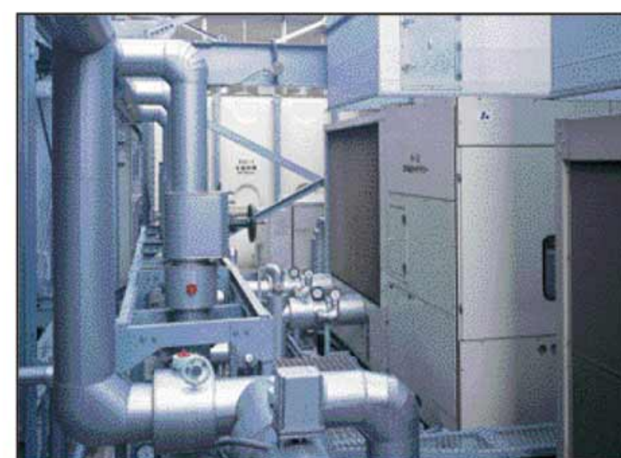
■空冷製氷ヒートポンプチラー(某学校)
