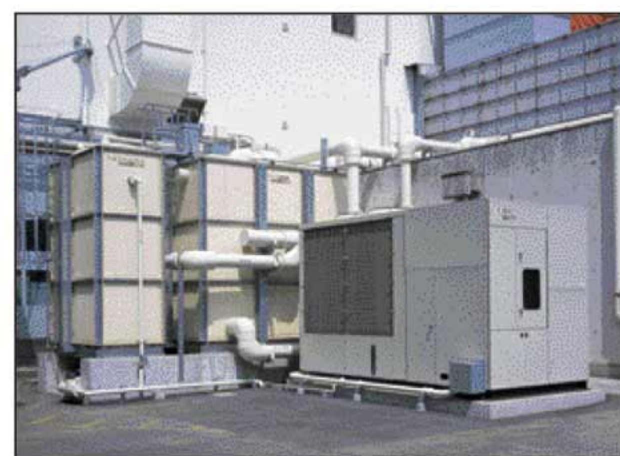
■チルド水供給装置(某飲料水メーカー工場)
