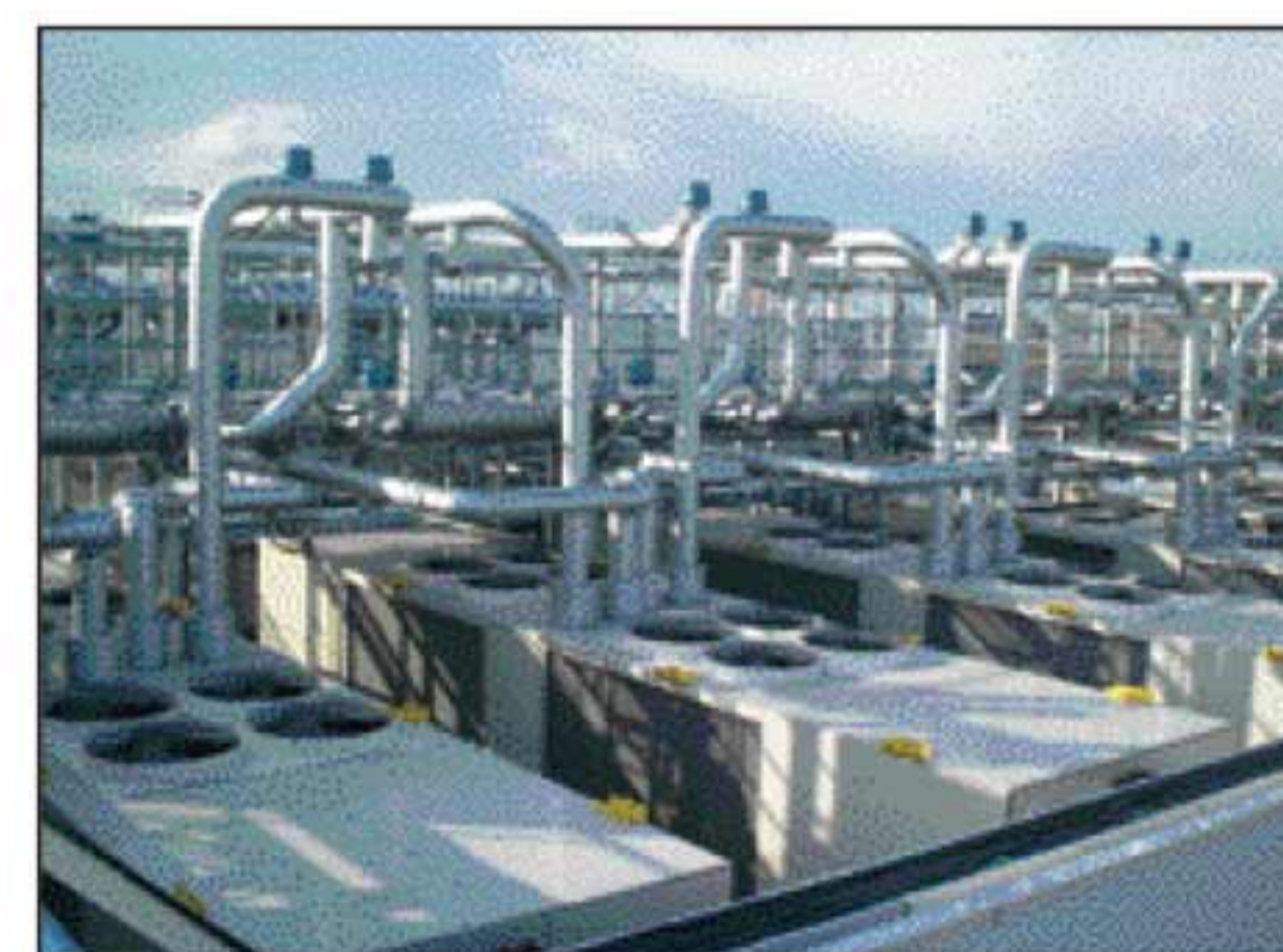
■チルド水供給装置(某乳業メーカー工場)
