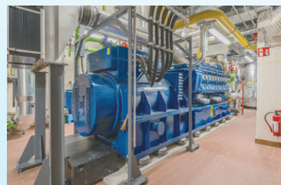
コージェネレーションシステム
