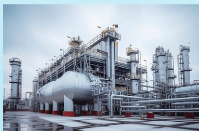
プラント設備
