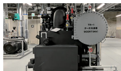
ターボ冷凍機
