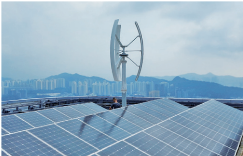
太陽光PVパネル・風車
