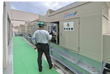
発電設備の点検
