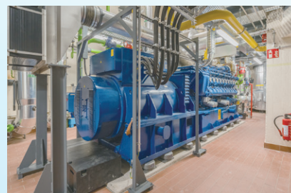
コージェネレーションシステム
