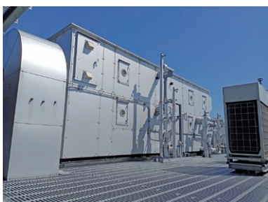
保守管理を担当する設備
