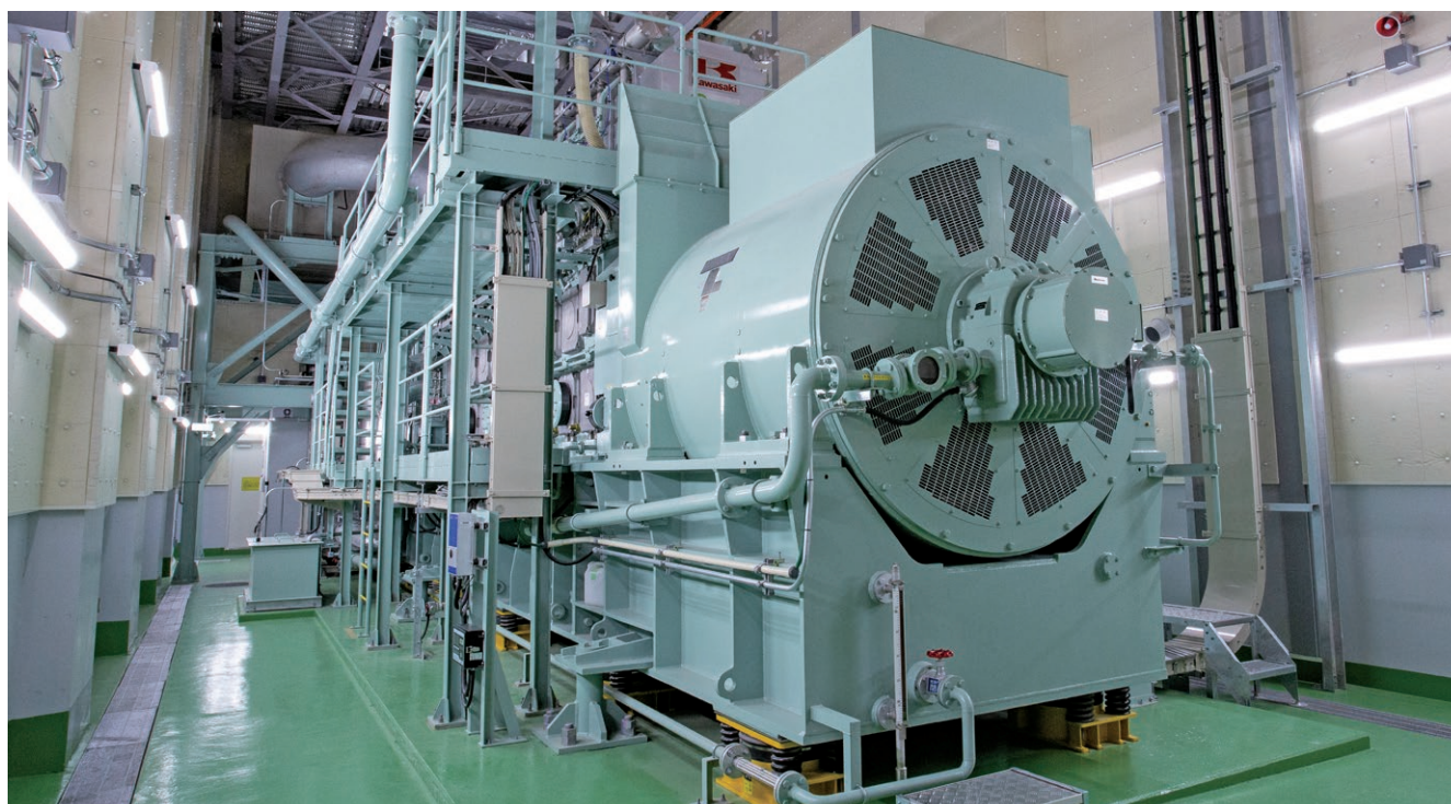
コージェネレーションシステム
