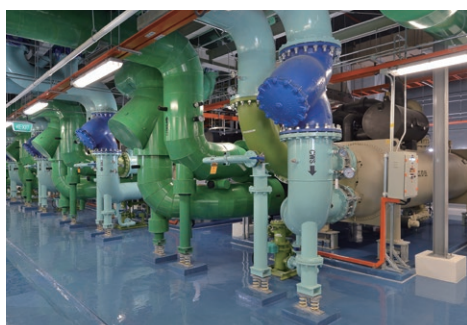
高効率電動冷凍機
