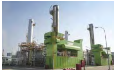
ペトロナス ファテライザー ケダ社 コージェネレーションプラント(マレーシア)
