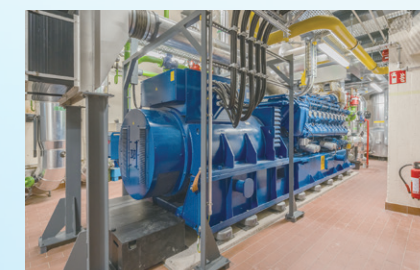
コージェネレーションシステム
