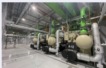
高効率チラー熱源設備
