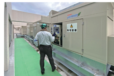
発電設備の点検
