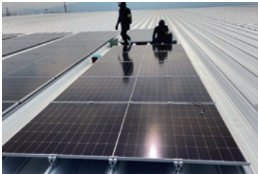
太陽光発電設備
