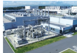
清原スマートエネルギーセンター プラント設備・建築・土木
