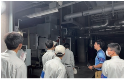
熱源機械室の見学
