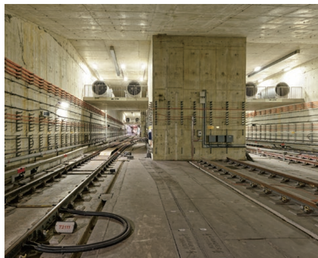
トンネル換気システム
