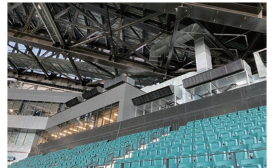
空調吹出し口
