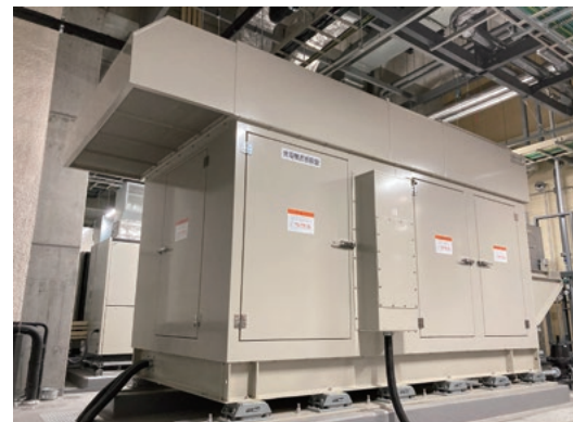
コージェネレーションシステム
