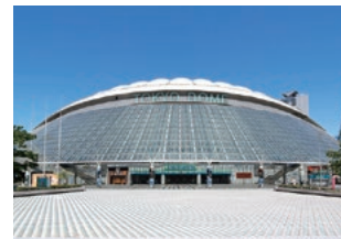
東京ドーム 空調設備
