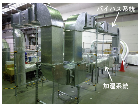
写真-2 加湿系統およびバイパス系統ダクトの外観
